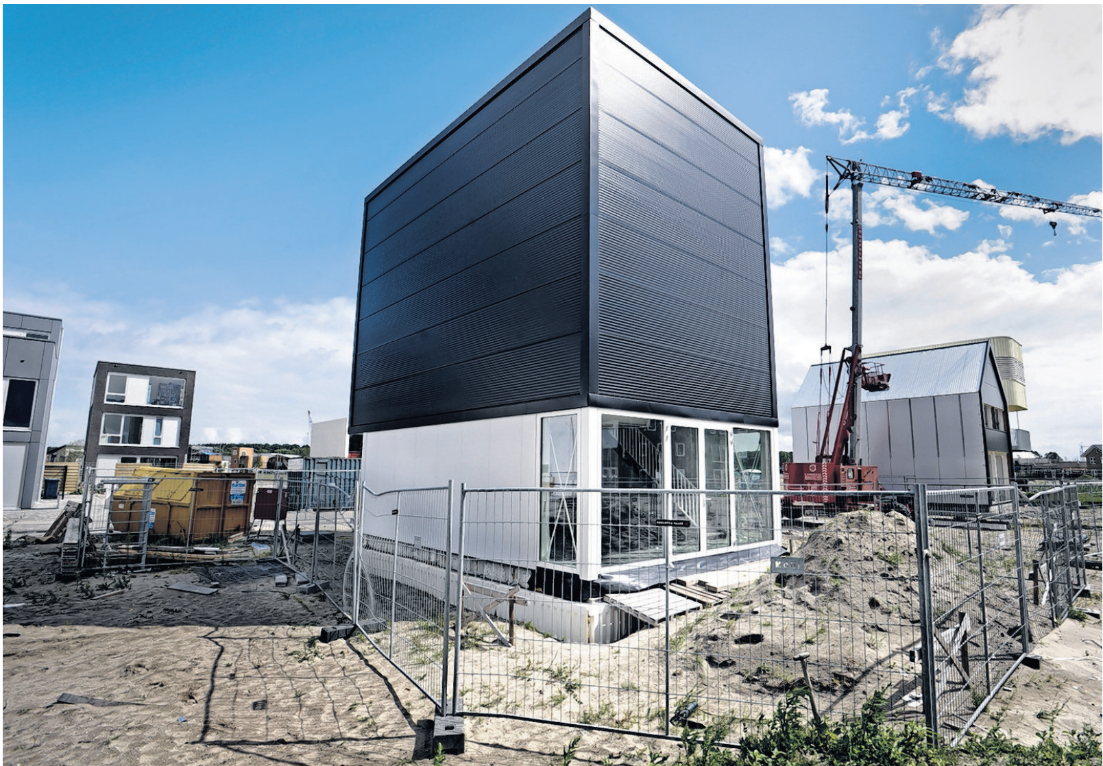
Een huis zonder ramen op de bovenste etages in Almere, gebouwd in strijd met de normale bouwvoorschriften. De lichtinval komt van boven. 'Je hebt geen ramen nodig', zegt opdrachtgever Peter Hermans. Foto Raymond Rutting / de Volkskrant
