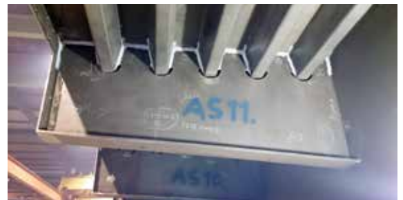
De troggen dragen de belasting via de dwarsdragers af naar de hoofdliggers
