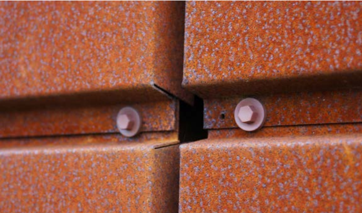
Bevestigingspunten zijn niet zorgvuldig gedetailleerd of weg gewerkt en corroderen
