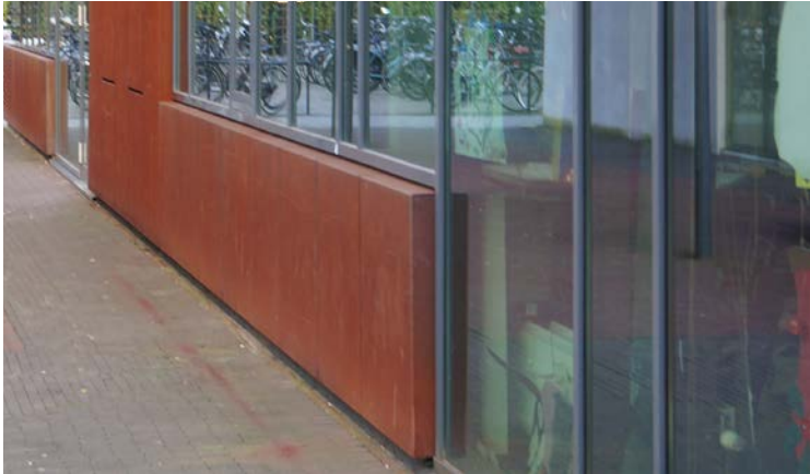
Een overhang zorgt voor een lekspoor van roestdeeltjes op afstand van de gevel. Ook direct langs de gevel hopen vuil en roestdeeltjes zich op
