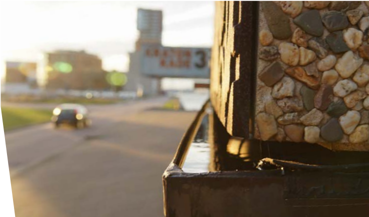
Randjes en hoekjes in de gevel en kozijnaansluiten waar water blijft liggen en vuil zich ophoopt.
