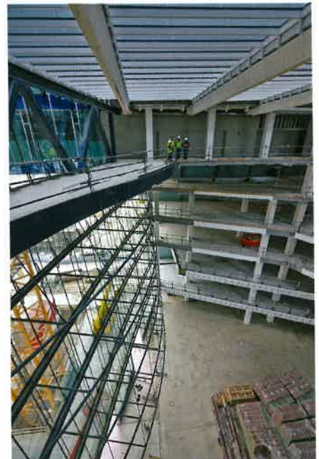
De pui hangt aan het vakwerk van de 6e verdieping.
