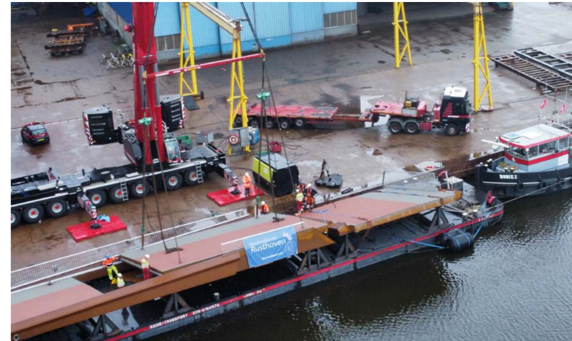
Hier zien we vanuit de lucht hoe Mammoet het beweegbare deel neerlegt op de ponton van Rodie waar een speciaal voor dit transport geëngineerd en geproduceerde stelling op staat, om de onderdelen in een schuinstelling te zetten. Dit is gedaan zodat enkele objecten die onderweg gepasseerd moeten worden te smal zijn en de uitstekende delen zo eroverheen hangen.
