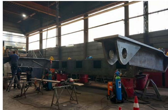
Hier is de ballastkist te zien tijdens de productie. Dit enorme onderdeel van weervast staal dat na vulling met ballast 65 ton weegt, is separaat geproduceerd van het beweegbare deel. Hiervoor is gekozen omdat de samenstelling van beide delen te groot zou worden voor het transport door de Weespertrekvaart.
