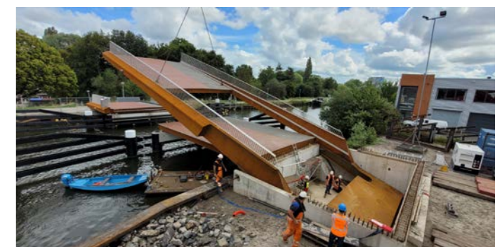
Na het lassen is de brug in de open stand vastgezet zodat de scheepvaart geen hinder ondervindt terwijl de kelder worden afgebouwd, het kelderdek wordt gestort, de E-kasten worden geplaatst en de aandrijving (de EHA's uit de tweede foto) worden gemonteerd. Nadat dit allemaal is afgemonteerd is de brug gereed voor draaien, en kan deze na zorgvuldig testen in gebruik worden genomen.
