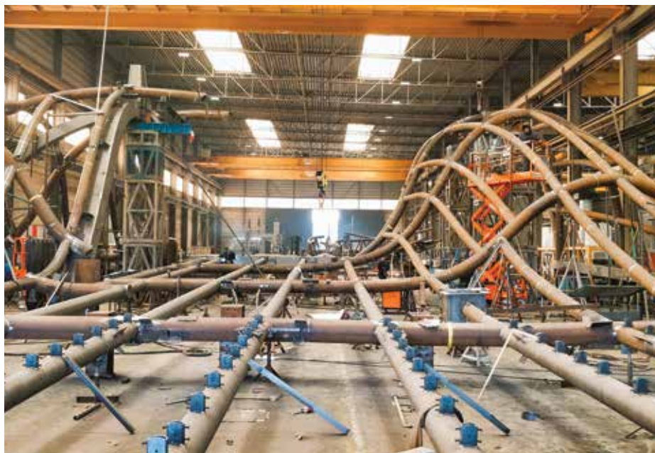
Staalconstructie glasdak met tijdelijke toogconstructie (links) voor correcte maatvoering. Blauwe 'potjes' voor montage glaspanelen.
